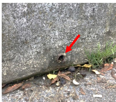
Abb. 25: Abflussloch in Steinwanne
